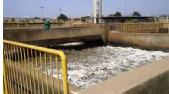
Figura 36 - Tanque de Aeração
