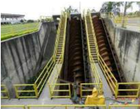
Figura 39 - Elevatória de recirculação de lodo
