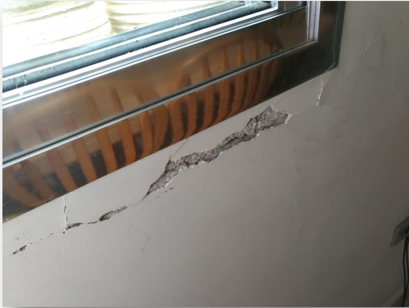
FOTO 31 Vista peitoril da janela
