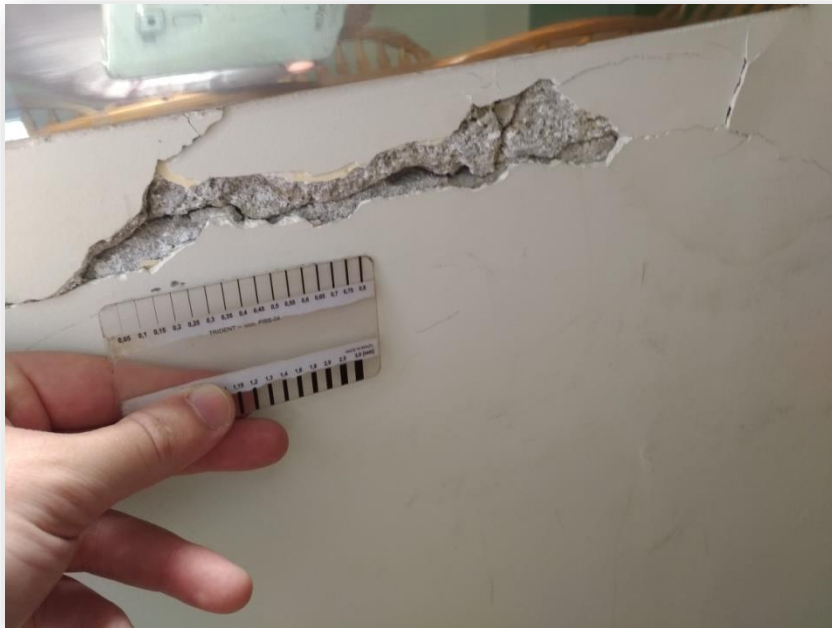
FOTO 32 Identificação de avaria no peitoril da janela, na Sala de jantar
