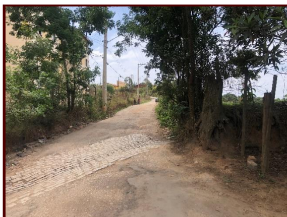
Figura 4.16 – Condição ruim de escoamento de águas pluviais. Estrada José Conceição.
