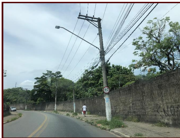
Figura 6.1 – Rede Elétrica – próximo ao acesso ao empreendimento.
