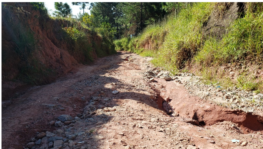
Figura 19: Vista de trecho com erosão na Via Tokuda
