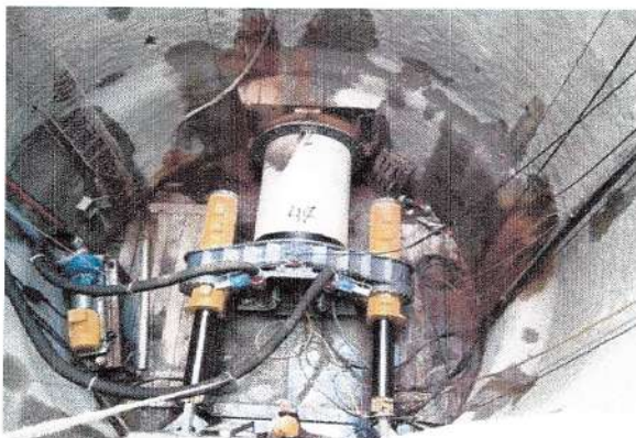
Figura 48 - Máquina Tuneladora ITi-16
