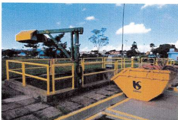
Figura 37 - Gradeamento fino Fonte: Sabesp
