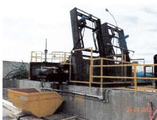
Figura 38 - Gradeamento grosso Fonte: Sabesp
