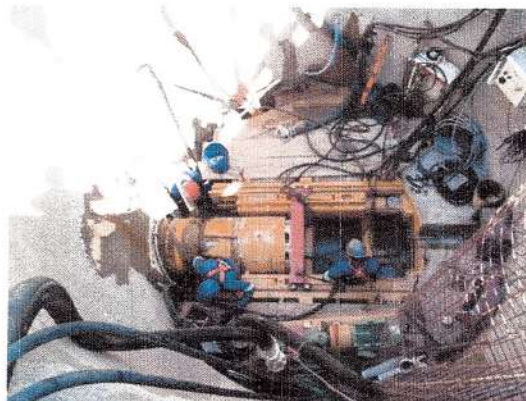
Figura 49 - Emboque Equipamento CT Jaguari
