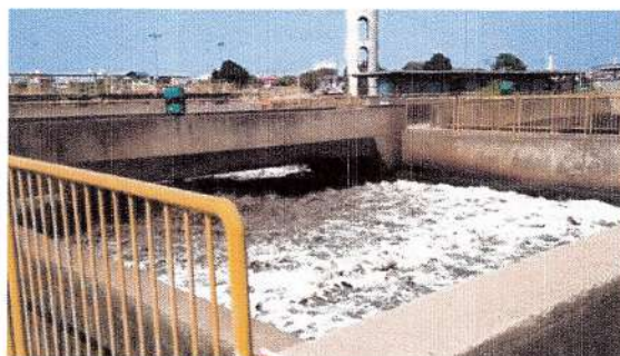
Figura 40 - Tanque de Aeração
