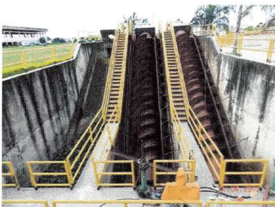
Figura 43 - Elevatória de recirculação de lodo
