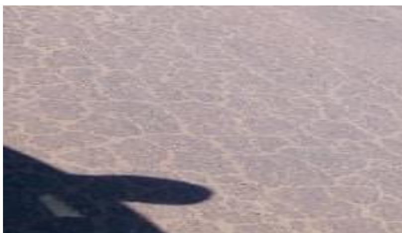
Figura 7.5 - Detalhe das fissuras no asfalto
