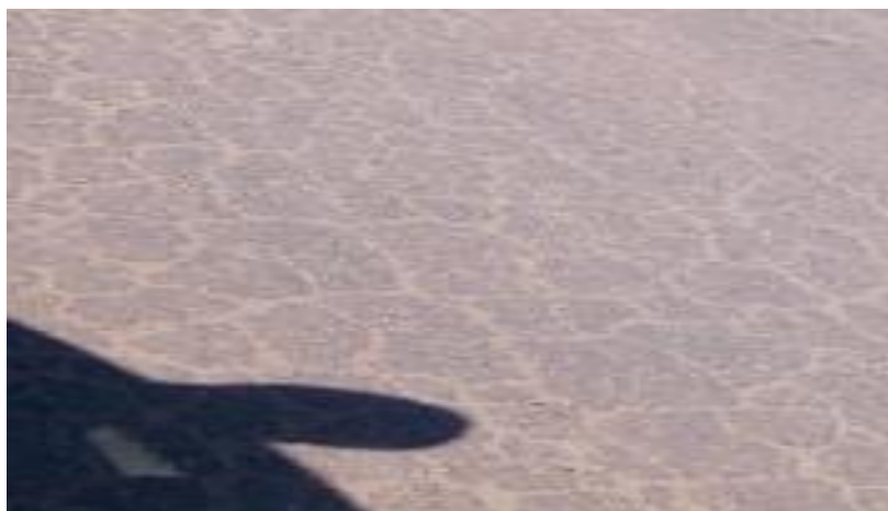
Figura 7.4 - Detalhe das fissuras no asfalto
