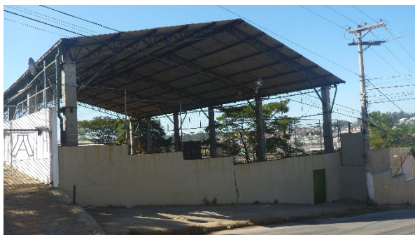
Foto 5.35 – Quadra da Escola Estadual Dr. Giovanni Battista Raffo, Rua Giovanni Baptista Raffo
