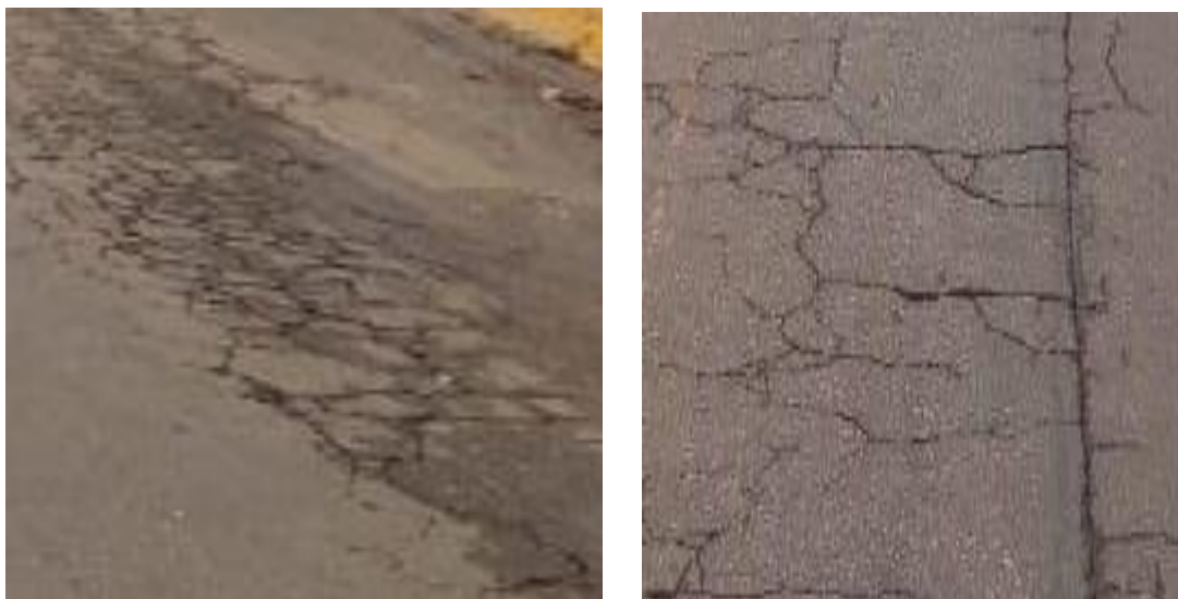
Figura 7.5 - Detalhe das fissuras no asfalto
