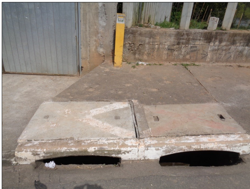
Figura 48: Drenagem R. Valdecir Ferreira dos Reis. Fonte: Master Ambiental, 2019.
