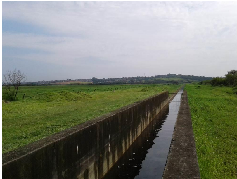
Figura 69: Canal artificial de lançamento da Sabesp no Rio Tietê, visada sentido Norte e Rio Tietê.
