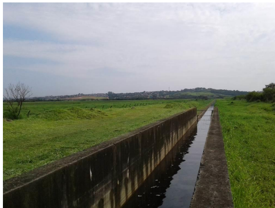
Figura 13: Figura 3.1-3: Canal artificial de lançamento da Sabesp no Rio Tietê, visada Norte e Rio Tietê. Coordenadas: 365437,101 7397944,232.
